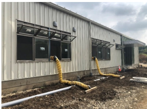
【写真②】送風機による換気(室外側)
