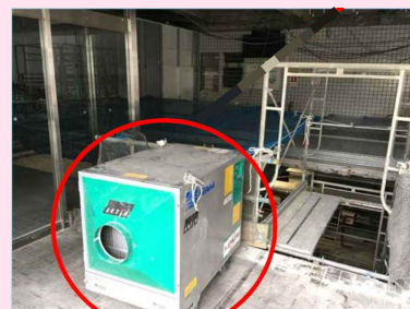
集塵機を設置し室内の換気を実施
