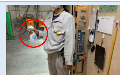
EVの操作盤等の消毒を徹底
