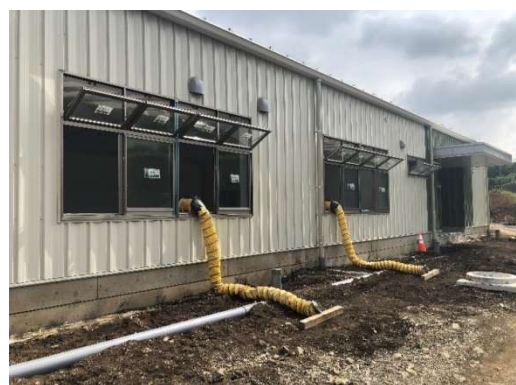
【写真②】送風機による換気(室外側)
