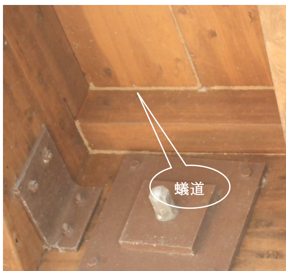
写真 2.2.5 しろありの蟻道の事例
